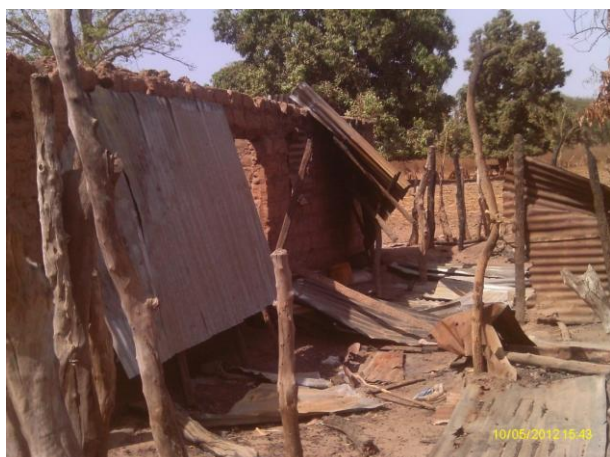
Maison détruite à Sindian (Photo de COPI)
